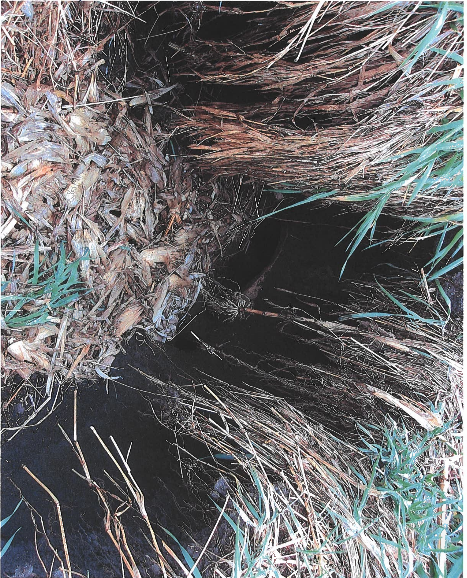
Clay FILL COLLAPSED
